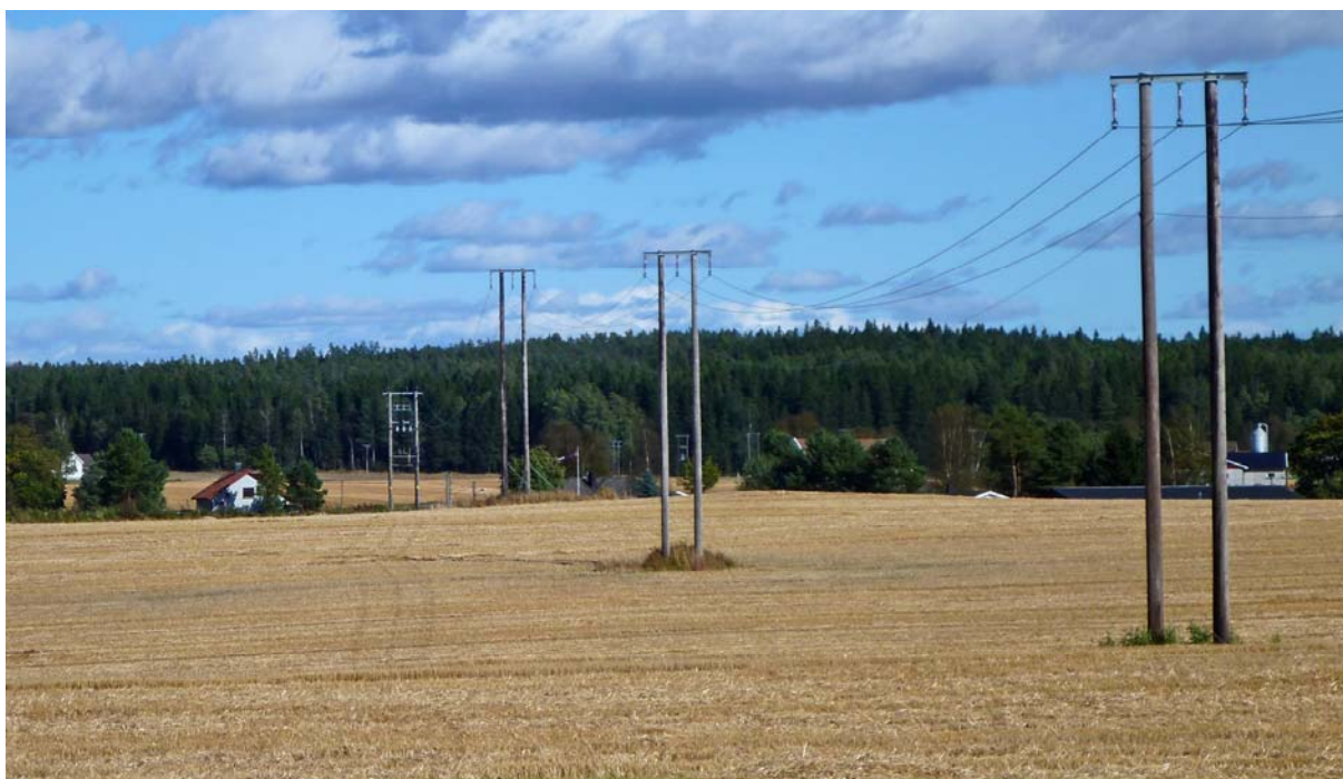
Figur 33. PMA Mast og LLE Høyspentledning på fulldyrka mark.
