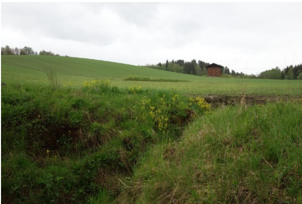
Erosjon i dråg og utrasing av kant
