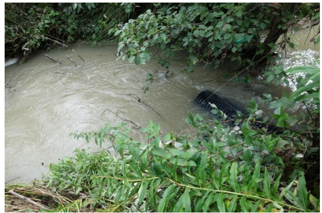
b) Dreneringsrør under vann ved høy vannføring
