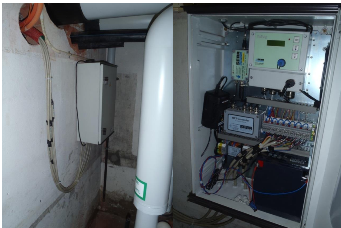
Figur 2. Ledninger fra sensorer føres inn i kjeller gjennom føringsrør og inn i skap hvor datalogger og batterilader er installert. Foto: Oddvar Vigdal.
