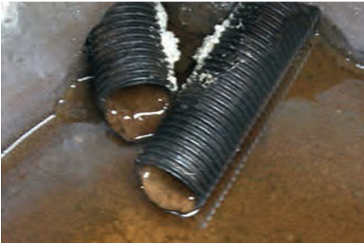
Grøftekum på areal med rustutfelling. Fleire sidegrøfter har innlaup her, og vidare transport i hovudgrøft. Tilgang til grøftespyling. Foto: Lars Sørdal, NIBIO.
