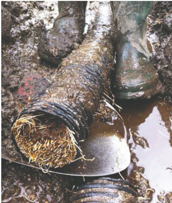
Rotinntrenging gjennom slissene som tettar drensør. Foto: Ståle Hustoft.
