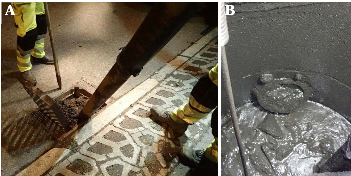
Bilde 8: Tømning av sandfang den 28.04.16. Bilde A viser GRO02 med masser opp til vei og utløpsrør fra kum som har gått tett (B). Kummen mangler dykker.
