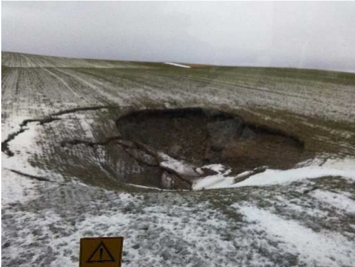
Bilde 1. Det kan bli store konsekvenser av brudd i lukningsanlegg. Bilde fra Romerike
