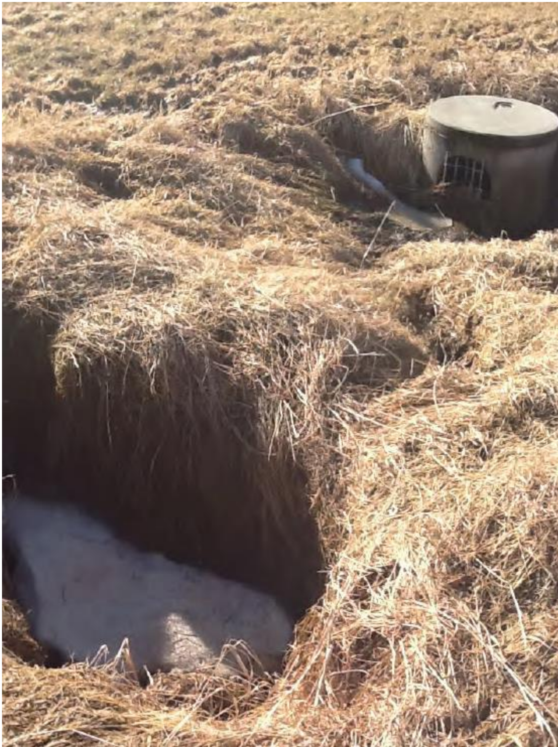
Bilde 5.3.1. Dårlige rister på kum som lett går tett, og erosjon foran kummen på grunn av utettheter.
