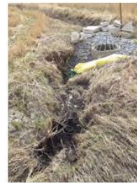
Mer og mer erosjon nedover.
