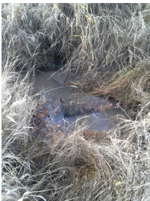
Bilde 5.15.1: Utløpet med forskjøvet rør og sedimenter som dekker utløpet.
