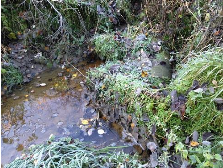
Bilde 5.8.2: Innløpet til lukkingen i oktober. Oppfylt med jord foran innløp, og planter og blader tett innløpsrista. De første rørene var ute av stilling.
