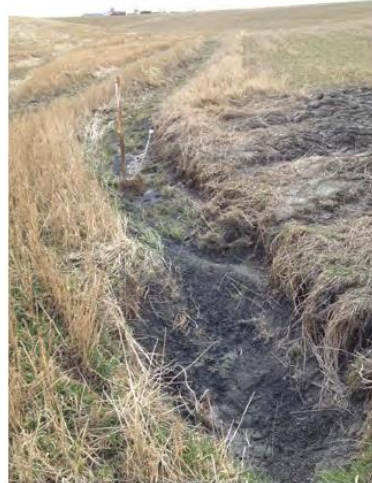
Vannet kom opp av jordhull og rant i delvis reetablert bekk over lukkingen.
