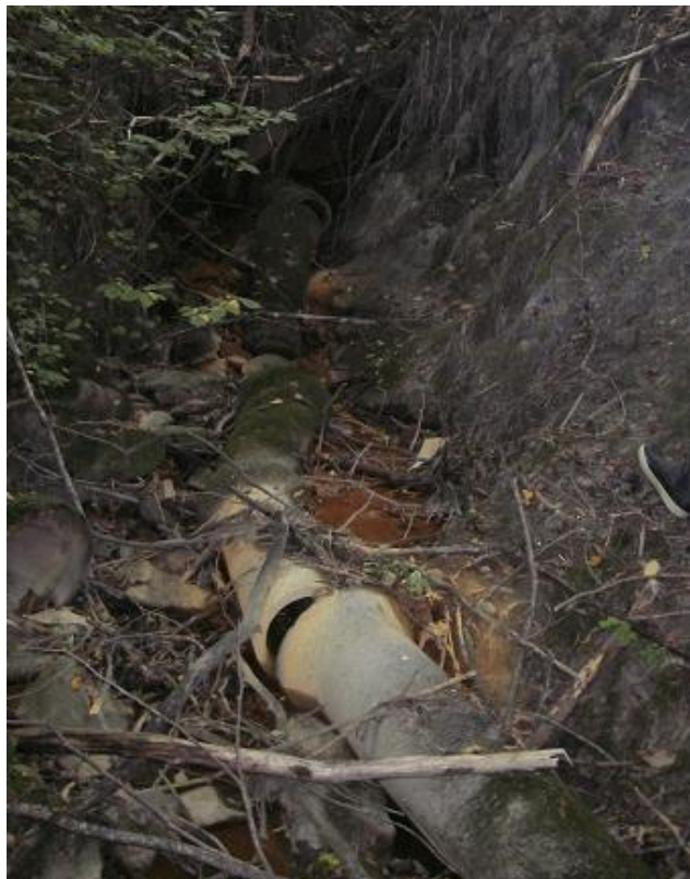
Bilde 3: I enden av rørgata spyles leira vekk i lekkasjer mellom de siste rørene, og det siste røret dras ut. Dette kan gjenta seg videre innover. (Foto: Atle Hauge)
