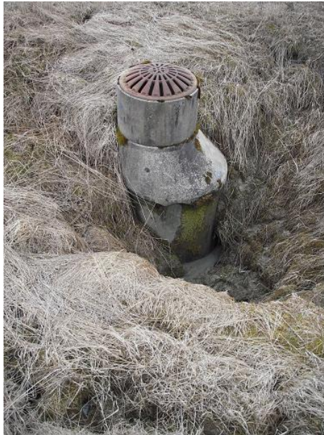
Bilde 2: Kummer med lekkasjer blir stående som piper i et erosjonskrater som kan gå helt ned til bunnledningen. Foto: Atle Hauge
