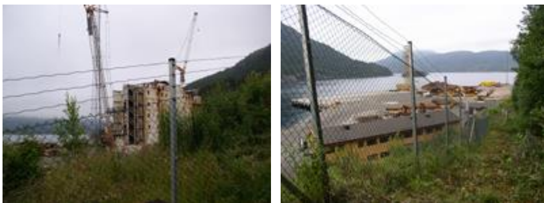
Figur 3. AF Decoms anlegg i Vats.
