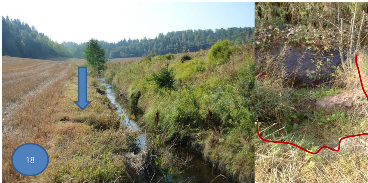
Figur 31. Langs bekkekanten var det noen få steder spor etter utrasing. Dette skyldes sannsynligvis graving rundt rørutløp og beskrives mer under delkapittel (3.2.3.2) om hydrotekniske systemer. Bildet er tatt sørover. Foto: A-G. B. Blankenberg.
