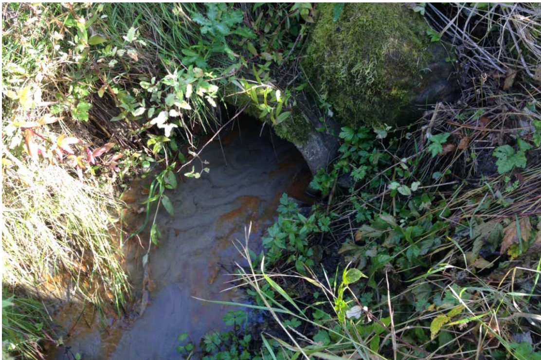
Figur 18. Bildet viser utløpsledning i åpengrøft på Roås, halvfull av sedimenter. Foto: A. Hauge.
