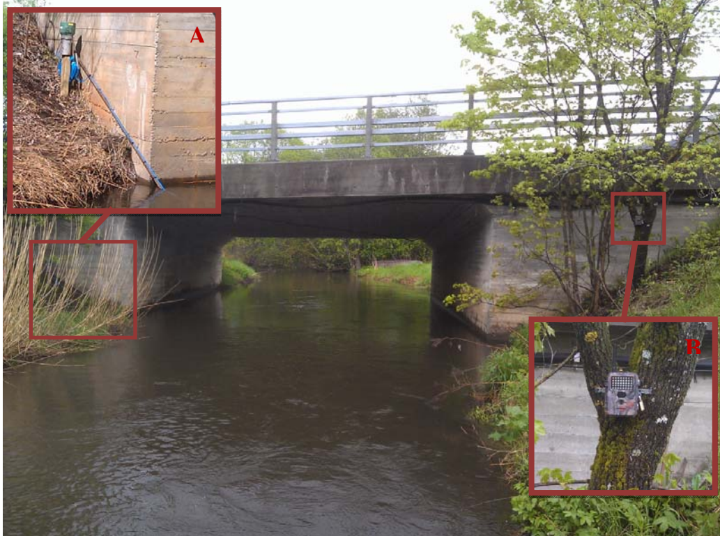
Figur 42. Viser installasjon av on-line sensor og viltkamera i Vigga nedstrøms anlegg.
