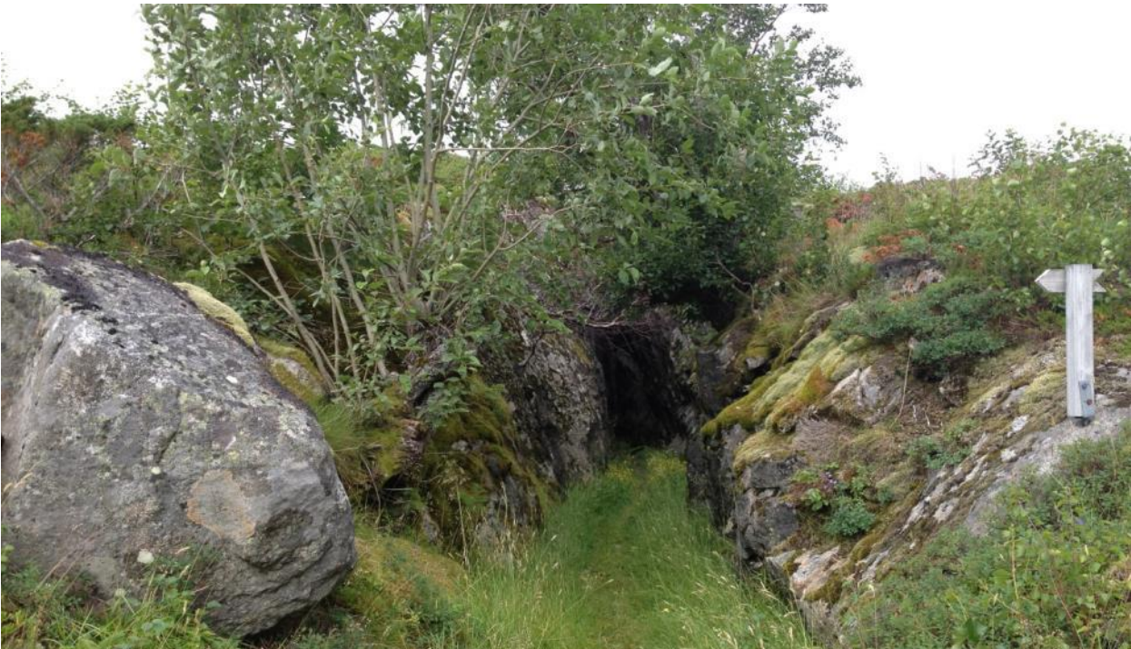
Figur 8. Seljebuske i tilknytning til bunkeranlegg. Kratt, busker og trær som står i tilknytning til installasjonene har høy prioritet ved ryddingstiltak. Foto: Maja S. Kvalvik.
