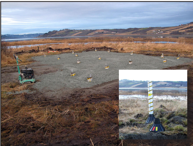
37. Det er viktig med solid grunnarbeid og drenering av grunn der det er nødvendig. Det finnes ferdige støypekjegler for bruk på fastmark av løsmasser, slik at stolpene får en bred og solid forankring.
