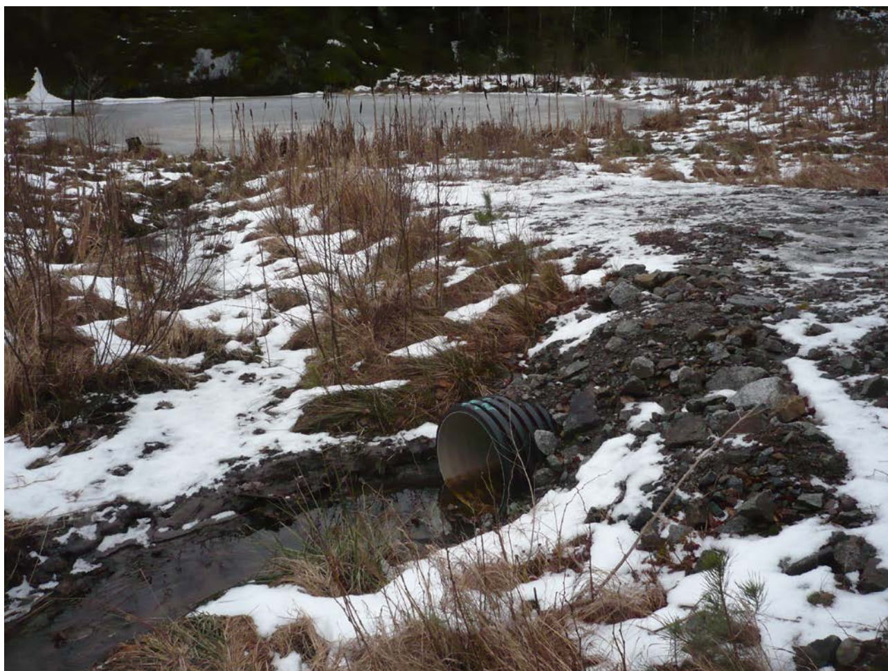
Figur 6. Kulvert i Hagabekken ved Norbytjern. Tilsiget fra tjernet kommer inn nedstrøms kulvert. Prøvepunkt for prøvetaking ligger rett nedstrøms dette området.
