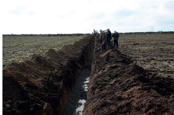
Kart som viser dreneringsforhold kan gi nyttig bakgrunnsinformasjon til entreprenører. Foto: Åge Nyborg, NIBIO
