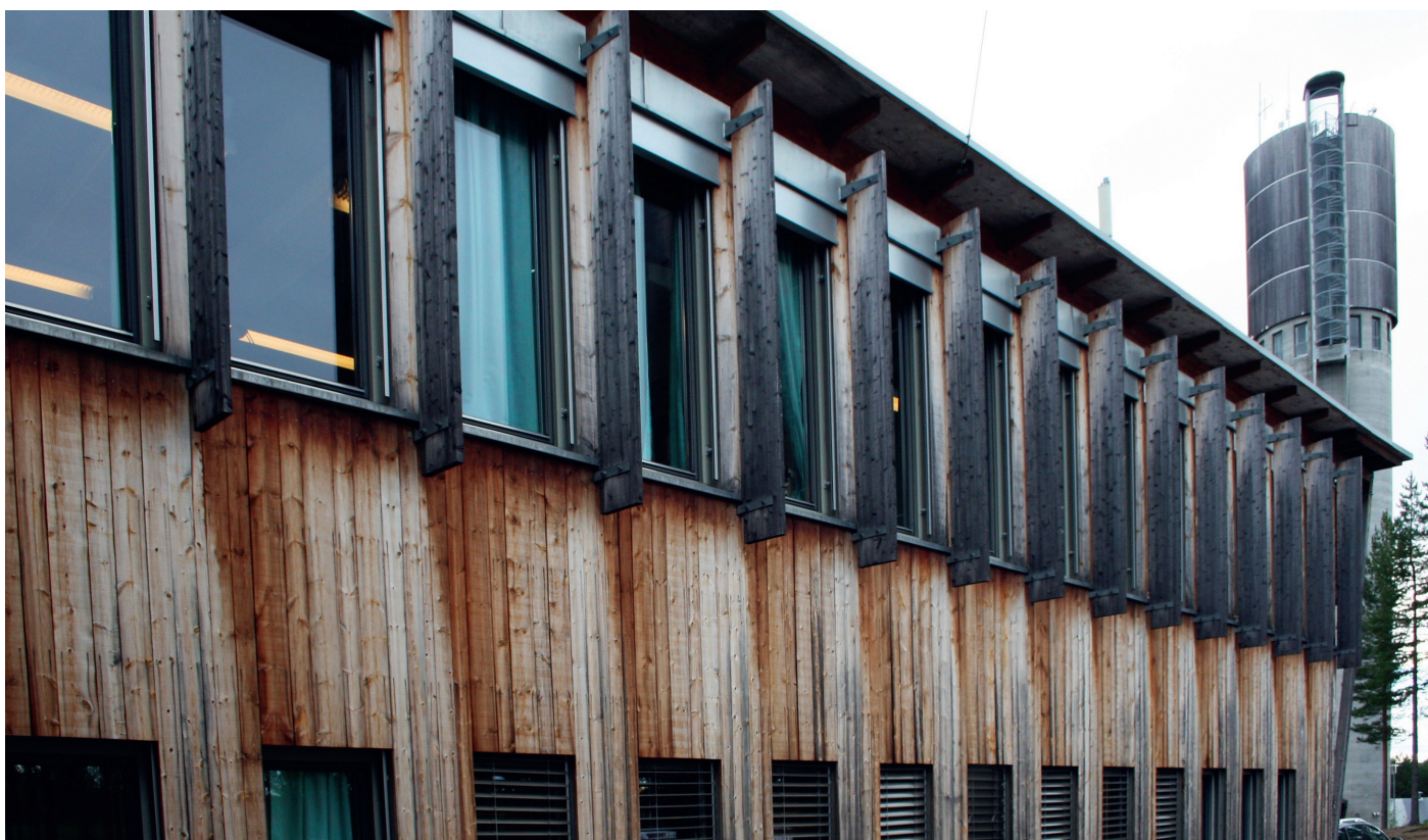
Solavskjermingen både skjermer og leder vann over denne fasaden. Bildet er av undervisningsbygget ved Rena Leir.
