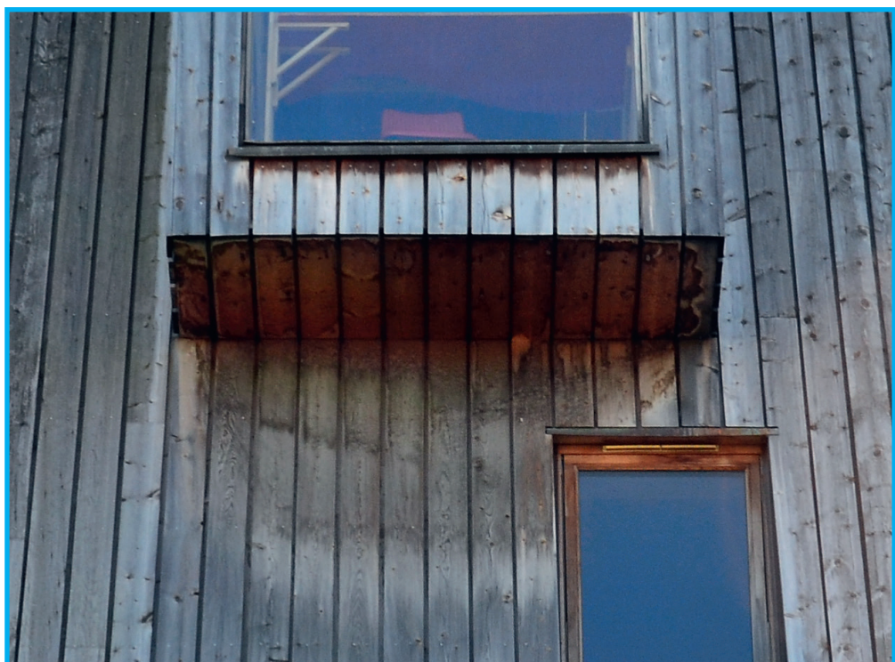
Vannakkumulering er synlig under karnapp.
