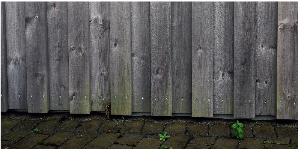
Algevekst på nedre del av en stående låvekledning.
