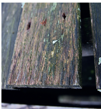
Råte i dekke av ubehandlet osp.
