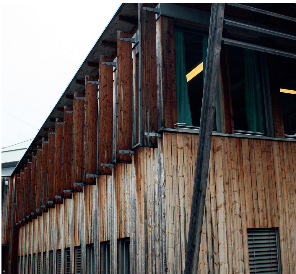
Vestvendt fasade, undervisningsbygget, Rena Leir. Preget av regn fra en drivretning.
