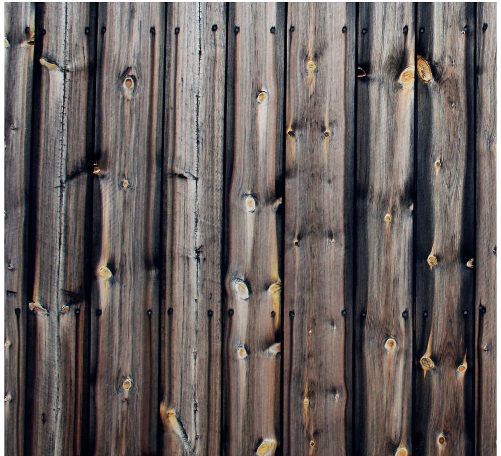
Avrenning av rustvann på furukledning.
