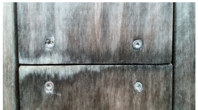
Liten avstand mellom kledningsbrodene.
