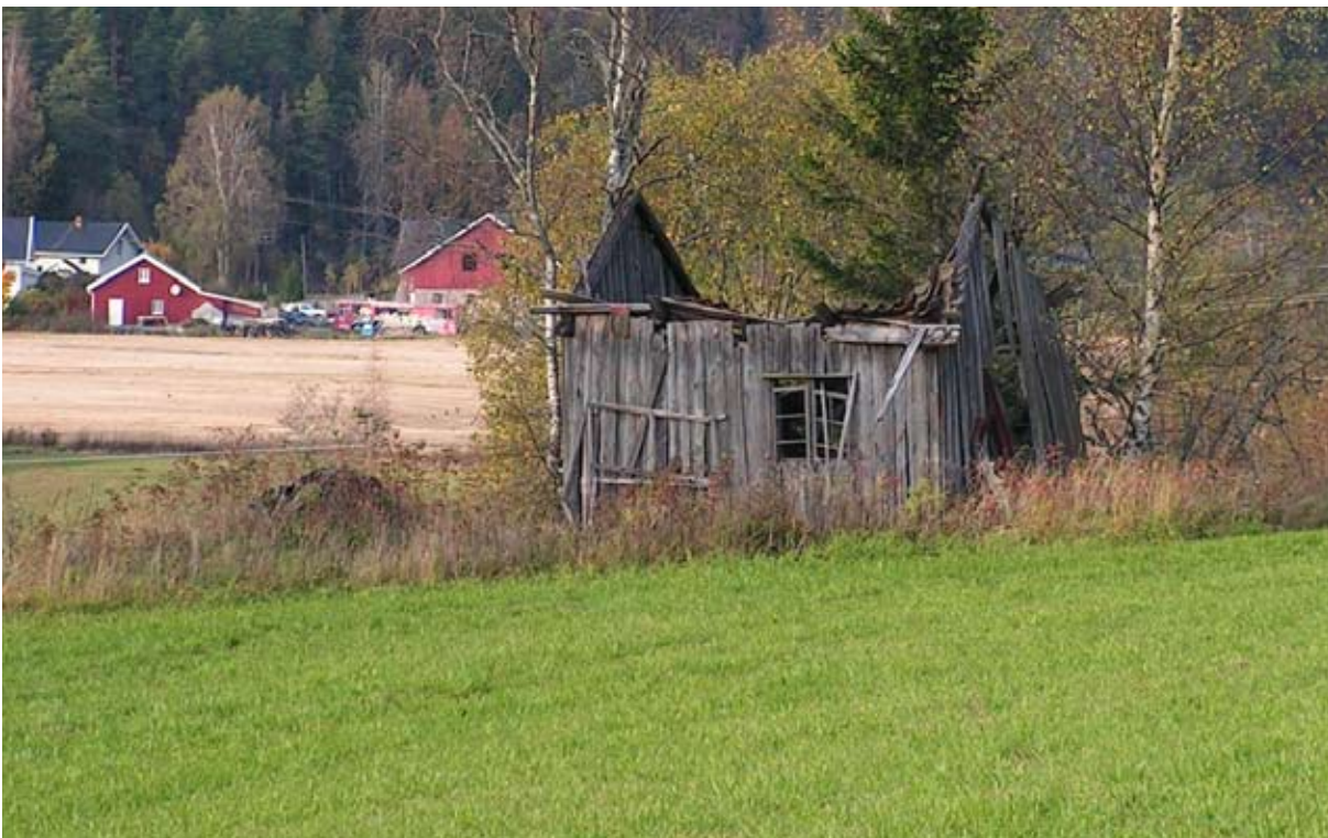
Vi ser at bygninger som er lite tilgjengelige og lite synlige fra tunet, er særlig utsatt for forfall når de har gått ut av bruk. Rester av smie i Akershus. Foto KAS.
