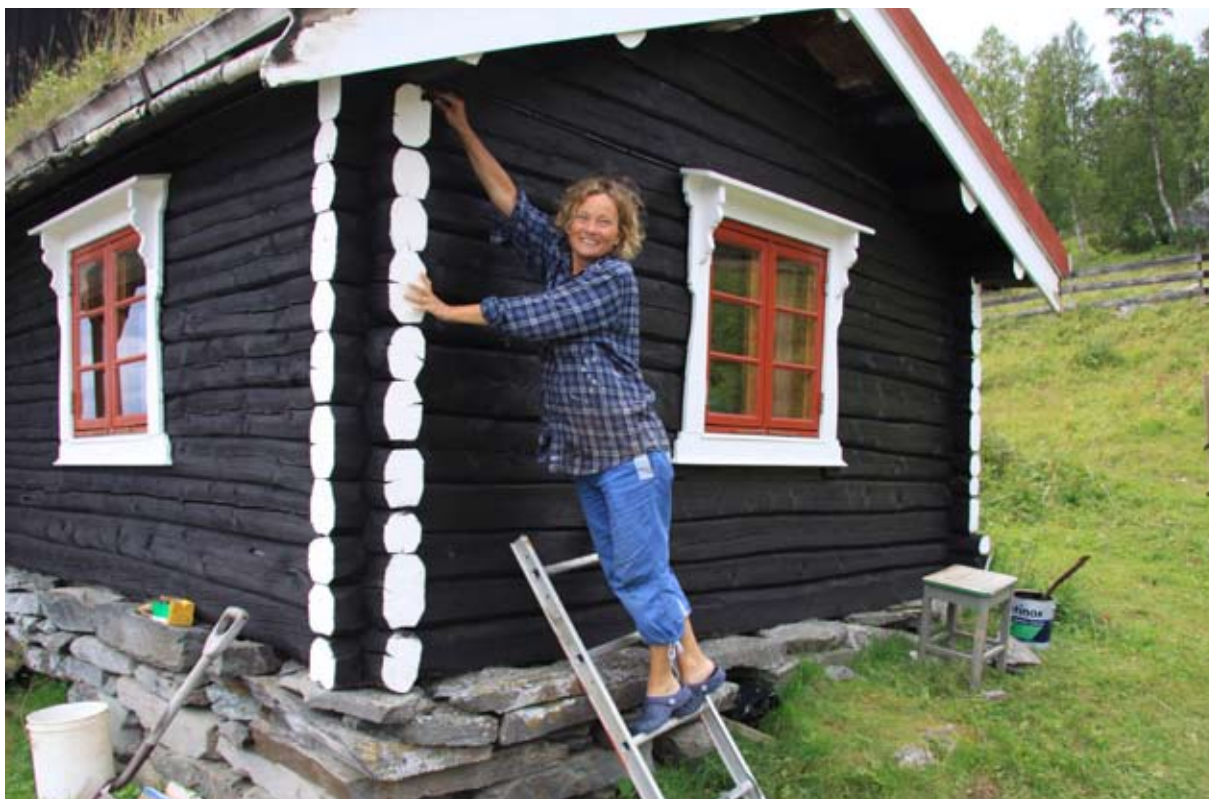
Mange grunneiere legger ned en stor arbeidsinnsats i å ta vare på gamle bygninger. Her er det seterstua som pusses opp. Os, Hedmark. Foto KAS:
