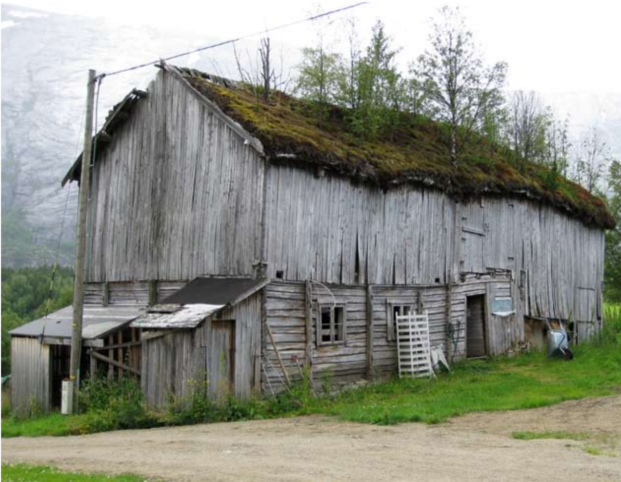
Det er til dels stor aktivitet i mange bygdelag for å finne ny bruk til de gamle låvene og hindre at de forfaller. Foto BOA.
