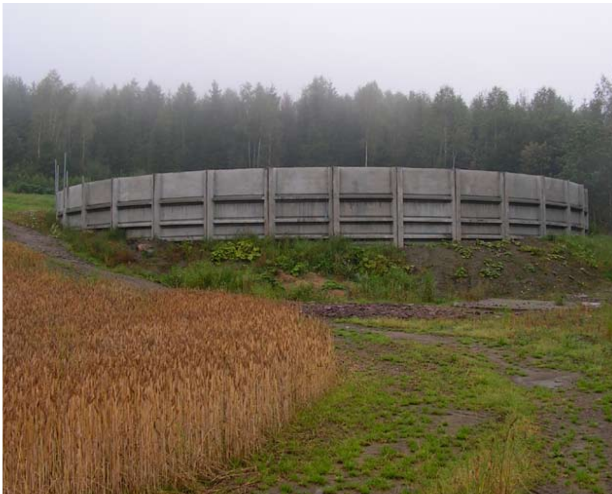
Gjødselkummen er et stadig hyppigere innslag i bygningsmiljøene i landbruket. Foto FRB.
