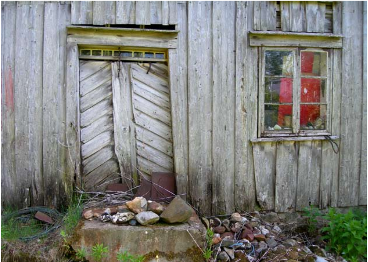
Forfallet inntreer nokså snart på bygninger som ikke er i bruk. Foto FRB.
