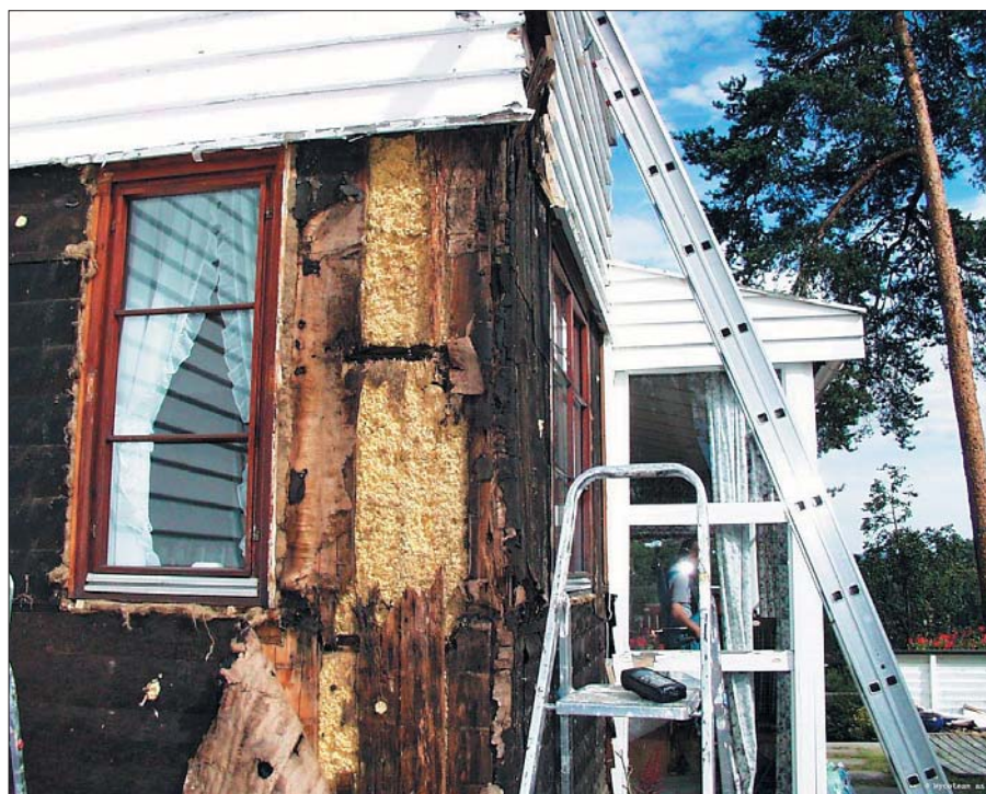
Så ille kan det gå når kledningen blir fuktig og sopp får fotfeste. Foto: Mycoteam
