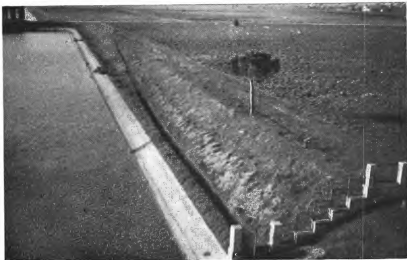
Fra Il Masocchio pumpestasjon ved kanal Della Selcella. Terrenget ligger her ca. \frac{1}{2} m under havflaten, mens vannstanden i kanalen holdes ca. 2 m under sjøvannstanden, dvs. 1\frac{1}{2} m under terrenget.
