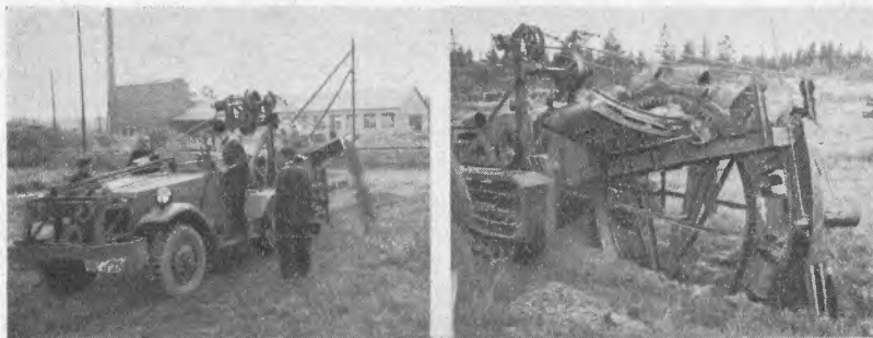
Fig. 4. Fra demonstrasjon av en finsk bygget gravemaskin ved hovedverkstedet til Pellonraivaus Oy i Tavastehus.
