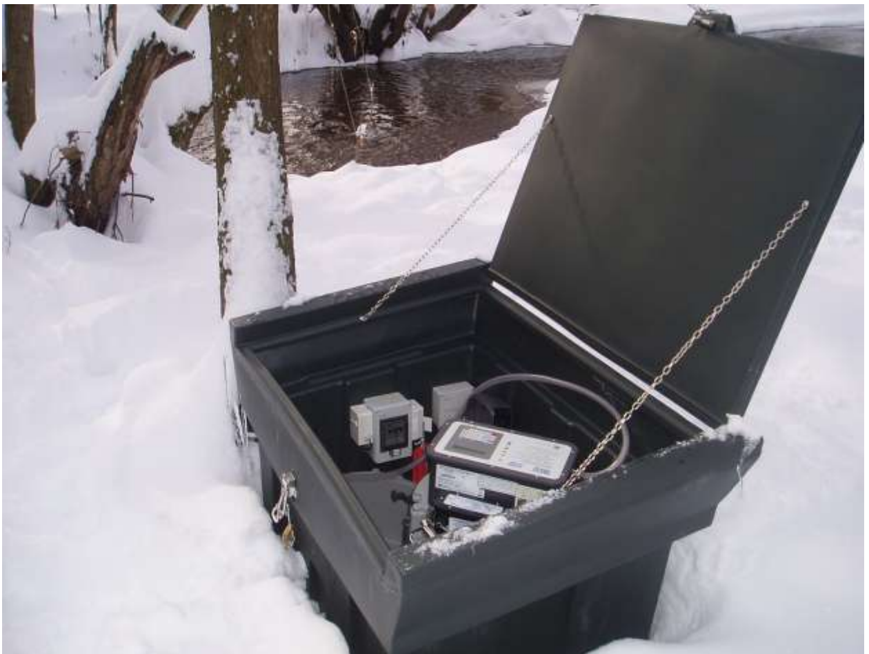
Figur 2. Frostsikret målekasse med automatisk vannprøvetaker og frostsikret sugeslange.
