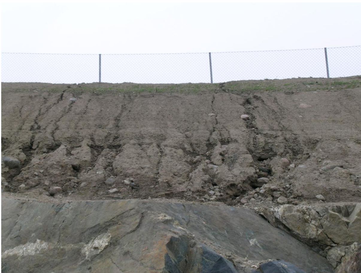
Figur 3. Betydelige erosjonsskader i veiskråning med siltige jordmasser. Foto: Trond Knapp Haraldsen
