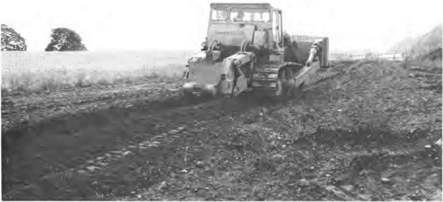
Dyp grubbing av topp-laget over avfallsfylling i Bærum, kjørt med 2 m's avstand. Dermed «åpnet» en hardpakka masser.
