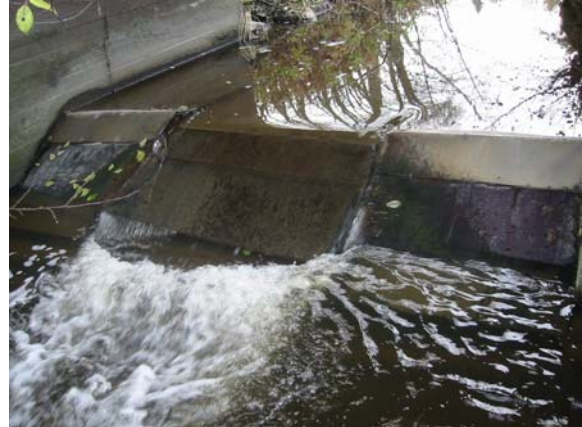
Terskel i dårlig stand (Foto: J. Deelstra).
