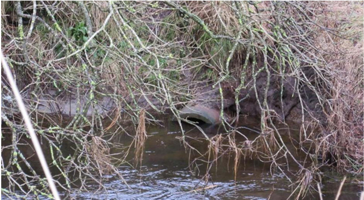
Eksempel på dreneringsrør som ligger under vann og dermed ikke fungerer etter hensikten. Foto: E. Skarbøvik.
