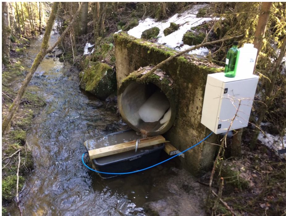
Figur 3. Installasjon av automatisk måleutstyr i avrenningen fra Åsland snødeponi.
