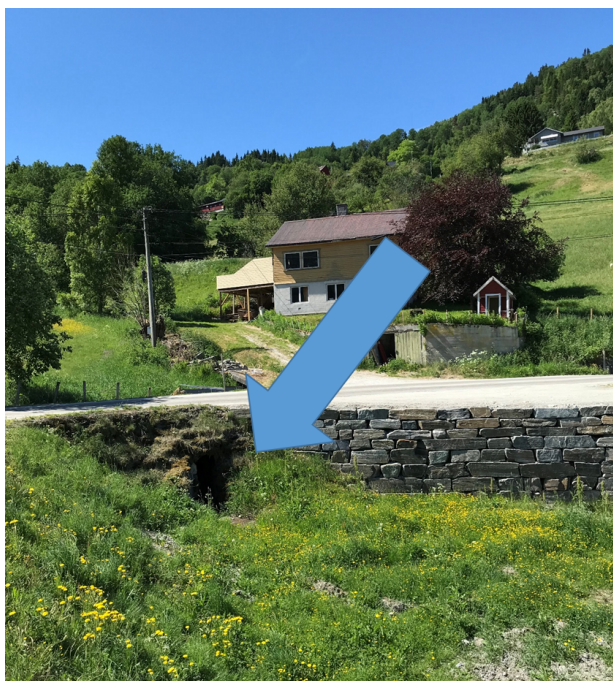
Figur 8. Kulvert hvor det til tider renner ut illeluktende og forurenset vann.
