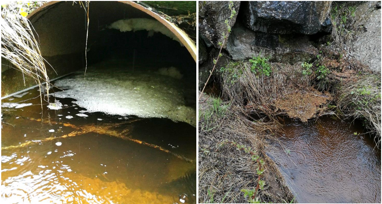
Figur 6: Det ligger en del pinner og annet organisk materiale både ved innløp og utløp til kulverten under veien.
