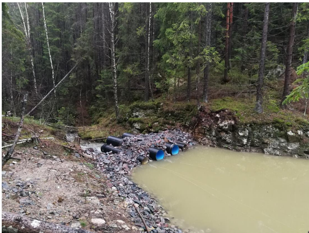
Sedimentasjonsdam ved ÅBY2 – Bekk fra Svartholt til Myrane mellom Blekketjenn og Nysteintjenna
