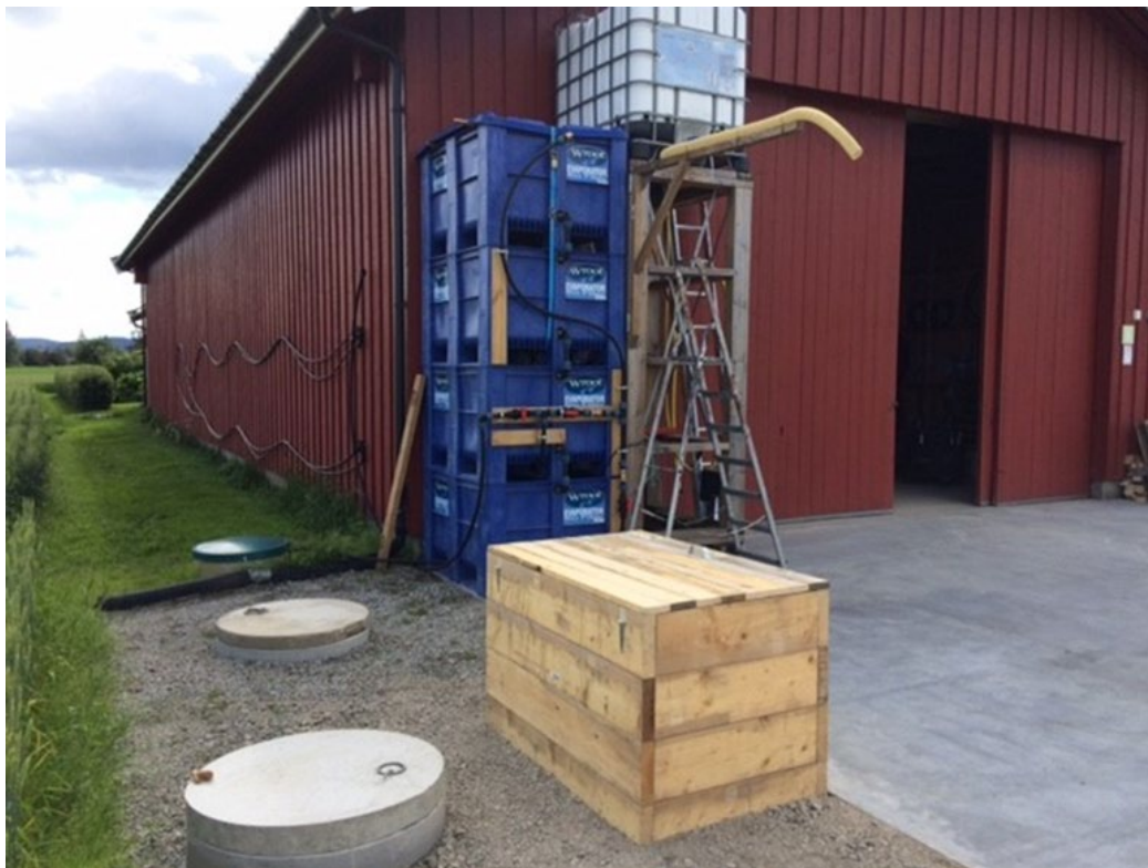
Figur 4 Vaskeplass med oppsamling av vaskevann til biofilter (Foto: NIBIO).
