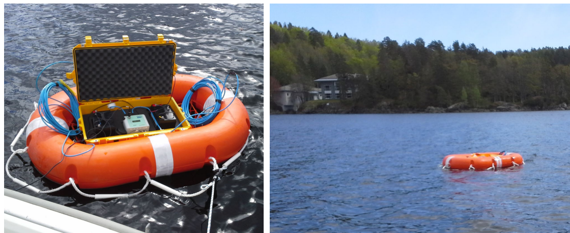
Figur 2. Miljøbøya Farris 3 med logger og sensorer samt plassering i forhold til Larvik vannverk.
