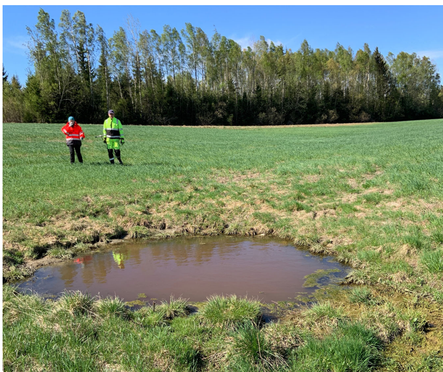
Figur 4. Hydroteknisk anlegg i bekkelukking har feil. Antakelig rørbrudd presser vann opp til overflaten hvor det har dannet seg en dam (Foto: Håkon Borch).
