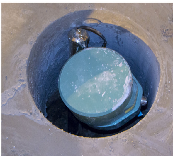
Logger senket ned i gulvet i Miljøbrønn 10, april 2014
