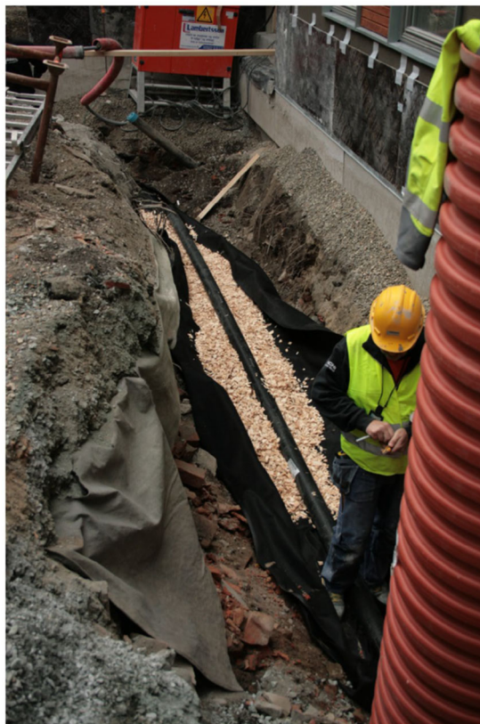
Figur 3. Under byggeprosessen ble det også etablert infiltrasjonsgrøft hvor takvann fra nybygg ble innfiltret ned ved i profil sør som ble liggende under nytt bygg. (Foto Anna Petersén NIKU).
