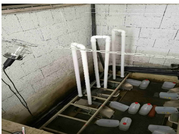
Dårlig drenering, grøftedybde, d = 0,5 m (c)
