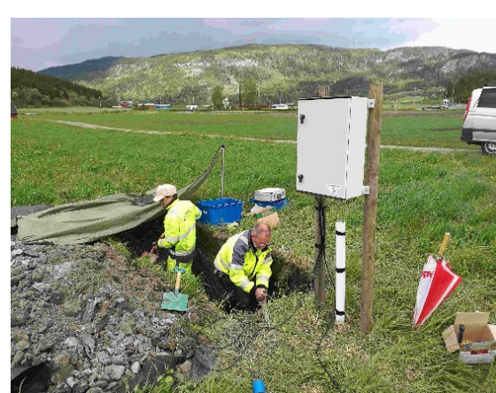
Installering av måleutstyr (d)
