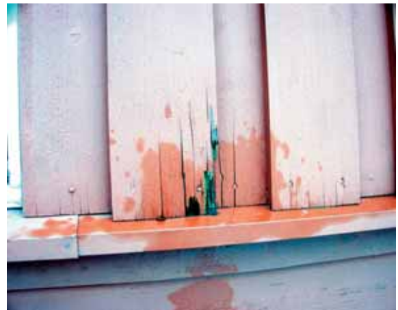
Bilde 4 Råtesoppskade i utvendig kledning. (Foto: Lone R. Gobakken)
