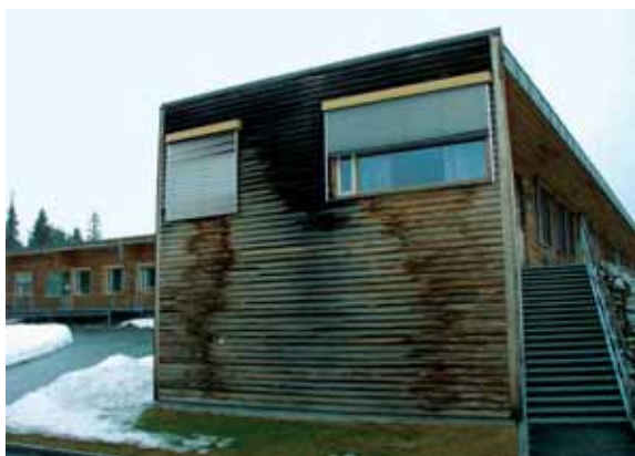
Manglende takutstikk vil gi oppfuktning av veggen og dette kan gi soppkader. (Foto: Mycoteam as)
