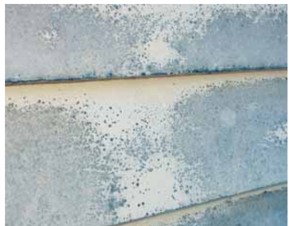
Bilde 5 Svertesoppskade på utvendig kledning. (Foto: Lone R. Gobakken)
