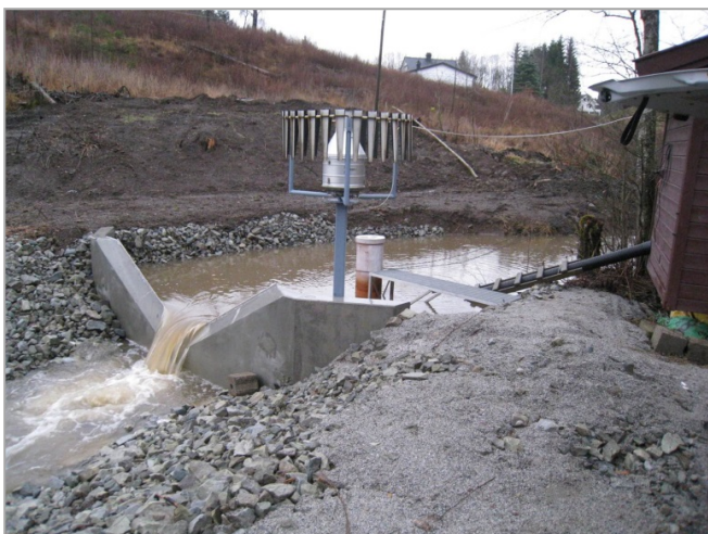
Figur 2. Det nye V-overløpet som ble anlagt i Kolstadbekken i 2012. Nedbørmåleren ses midt i bildet, målehytta til høyre. Foto: NIBIO.
