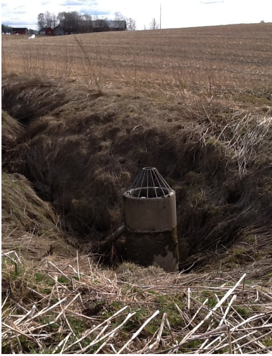
Erosjonsskade rundt en nedløpskum. Foto: A. Hauge, NIBIO.
