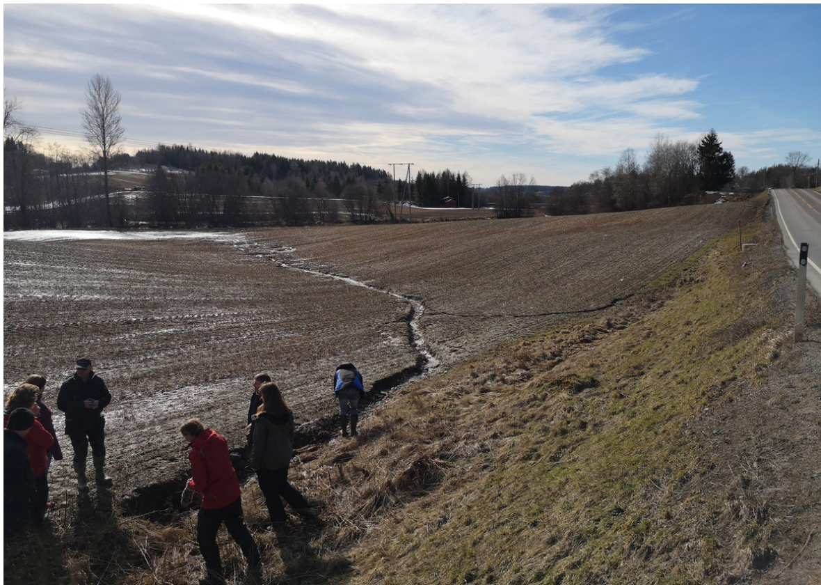
Erosjon som følge av avrenning gjennom stikkrenne under vei. Arealet nedenfor veien er vist i kartutsnittet over. Foto: Robert Barneveld, NIBIO
