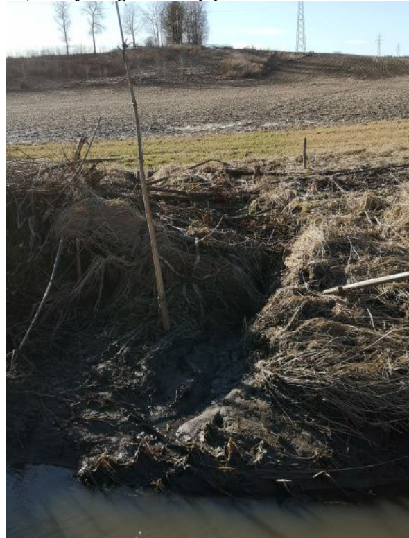
#17 Erosjon i grøfteutløp på vestsiden
