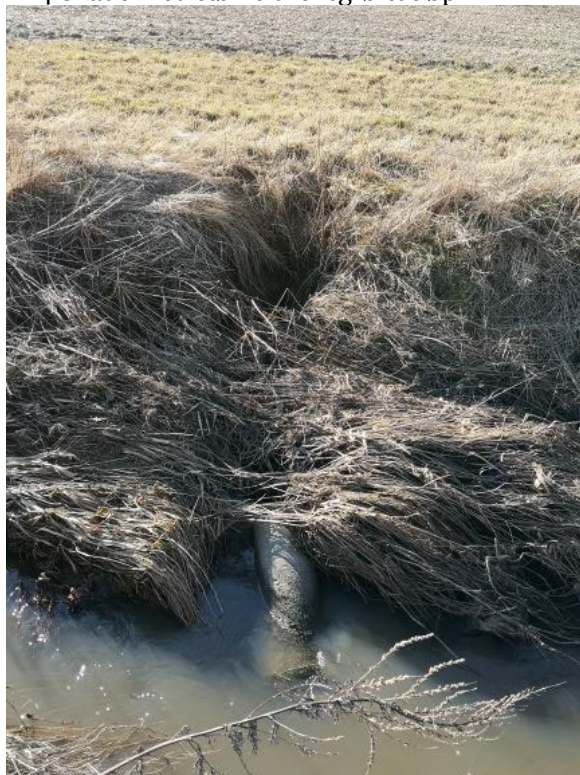
#24 Skader ved større drensgrøftutløp
