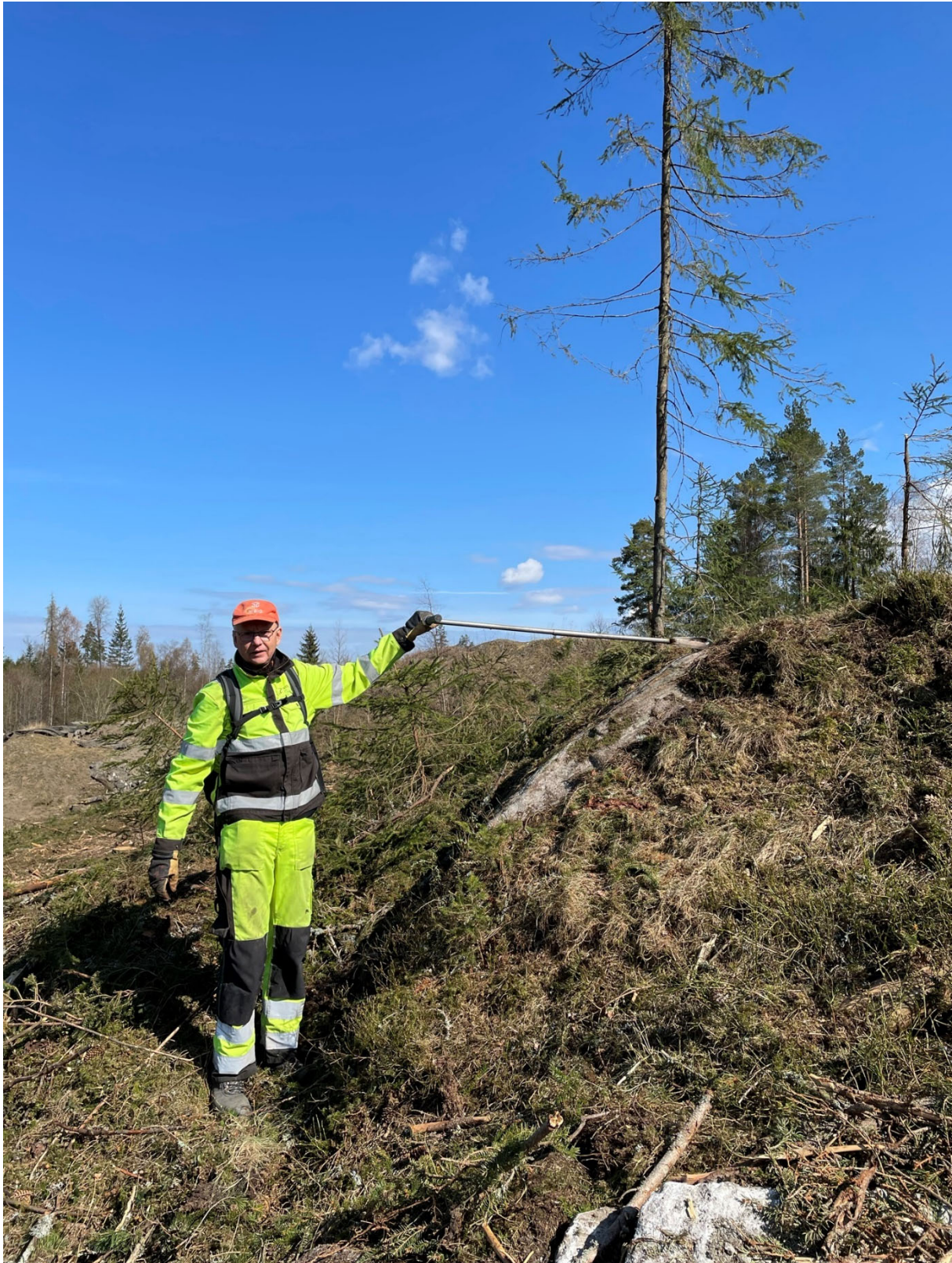
Figur 21. Fjellknausene av større størrelse må sprenges bort for å kunne få et jordbruksareal med god arrondering. Bilde viser hvor mye som må sprenges bort for å jevne ut terrenget (fra jordboret ned til hvor Trond K. Haraldsen står) (Foto: Monica Jayesingha).
