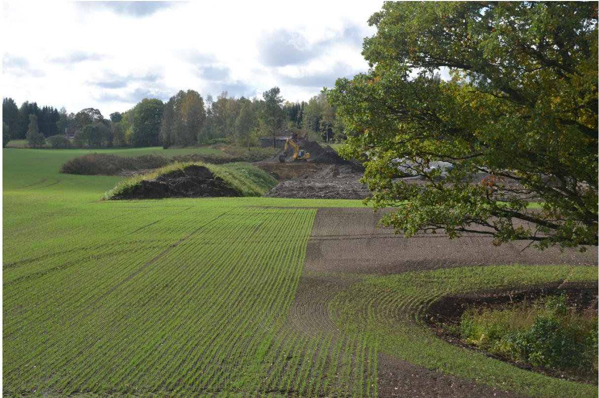
Figur 20. Opparbeiding av jordbruksareal ved jordflytting på masseuttak. Nyetablert jorde med nysådd høstvetne i forgrunnen er 1-1,5 m over gammelt terreng ved eika til høyre.
