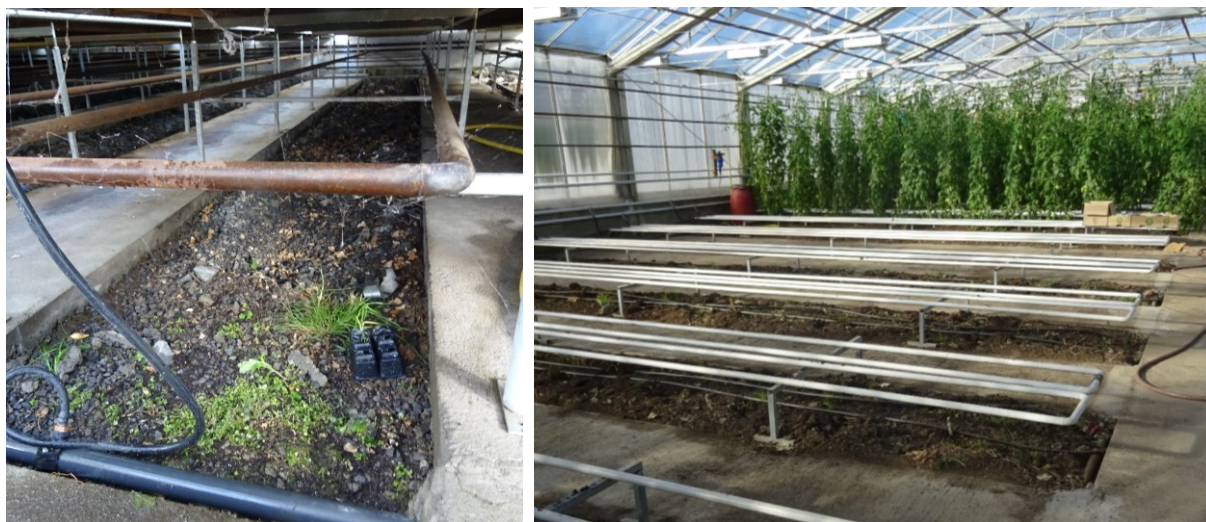
Figur 6. Bed mellom betongganger som er fylt igjen med grus (til venstre). Kan gjøres om til dyrkingsbed ved fjerning av grus og påfylling av matjord, kompost eller anna dyrkingsmedium. Bildet til høyre viser tilsvarende bed der grus ble fjerna ned til naturlig steingrunn (25-30 cm) og jord fra et nærliggende jorde ble fylt på.
