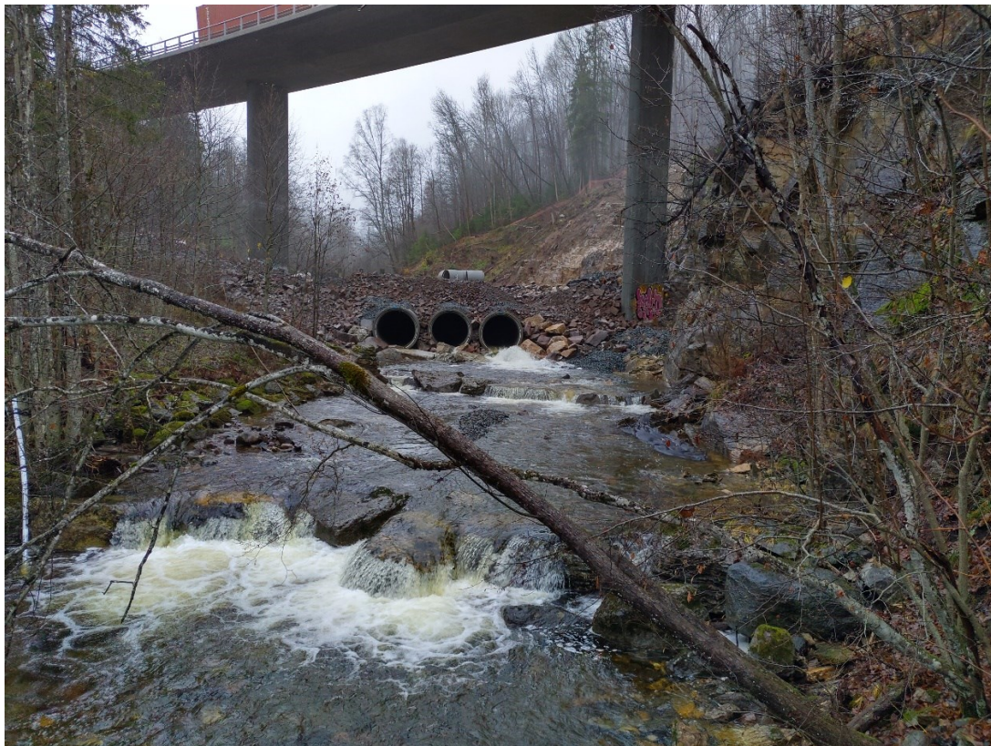
Øverst: Kulvert i Isielva under Bjørumbua raste ut med flommen september/oktober 2021. Dato: 05.20.21. Foto Johanna Skrutvold.
