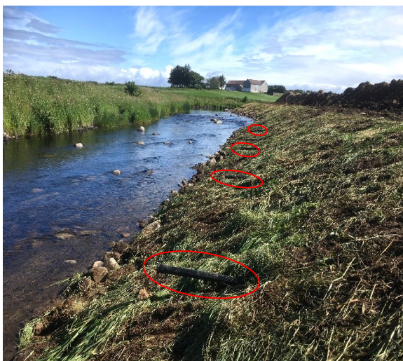
Dreneringsrør stikker ut med jevne mellomrom langs kanten på kantsonen
