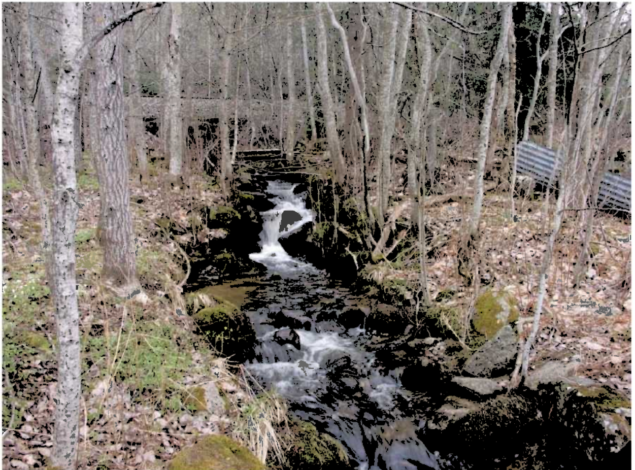
Figur 6. Nedre del av Dalsrubbekken. Vandringshinder ved kulvert under jernbane (Dønnum 2009).
