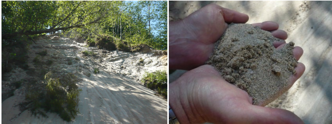
Figur 13. Naturlig rasskråning dominert av fin sand i terrasse-skrenten litt nord for overvåkingsbrønnen.
