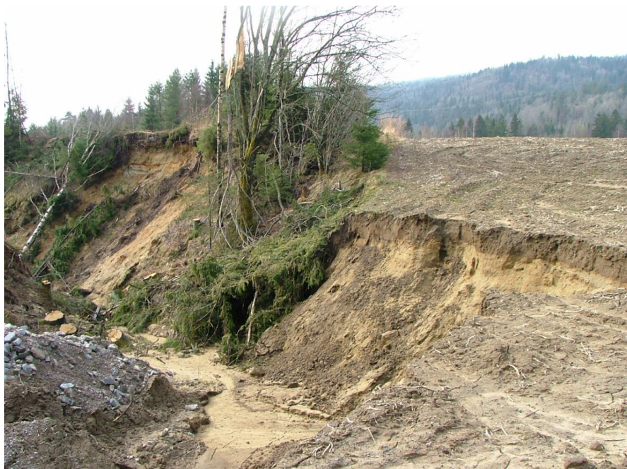
Figur 19. Ras i en ustabil ravineskråning på Rimstadmoen (Foto: Einar Kolstad).
