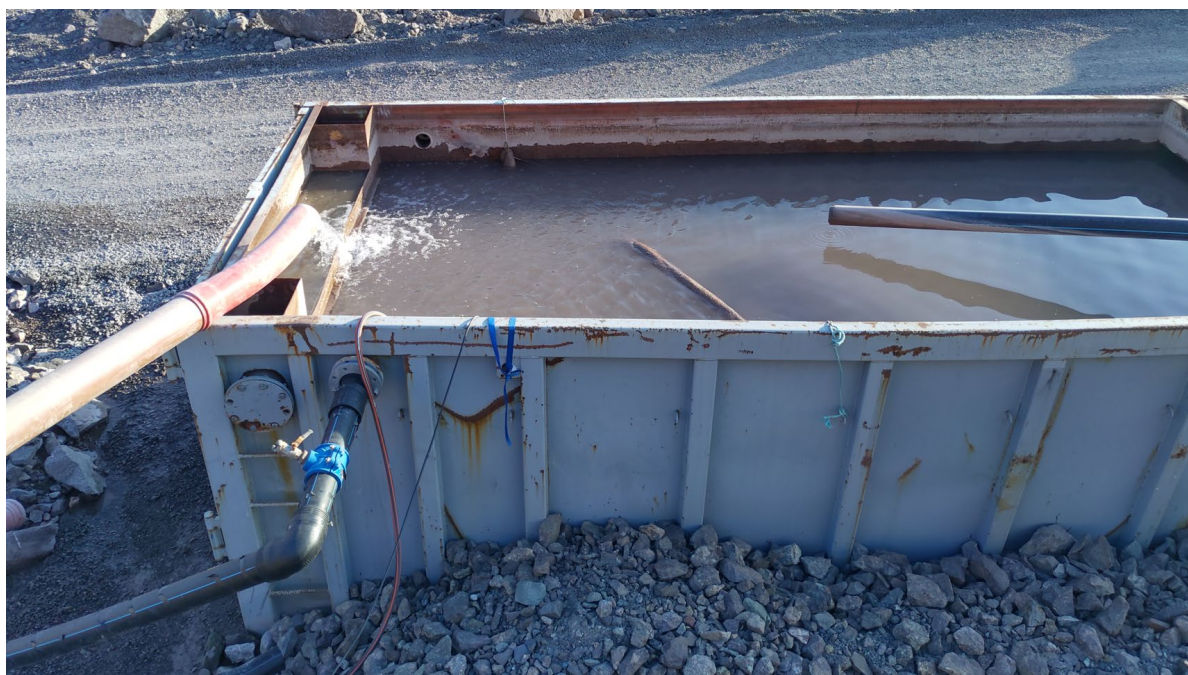
Figur 4. Container for utslipp av rensert og pH-justert tunneldrivevann med pumpe til nitrogenfilter (blå stropp).
