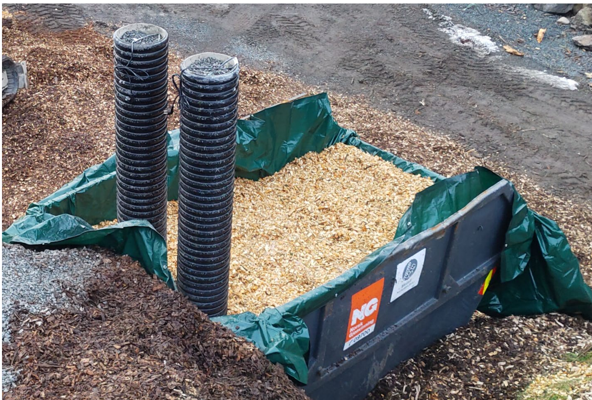
Figur 3. Container ferdig oppfylt med filtermaterialer og med innløpsrør fylt med singel for nitrifikasjon.
