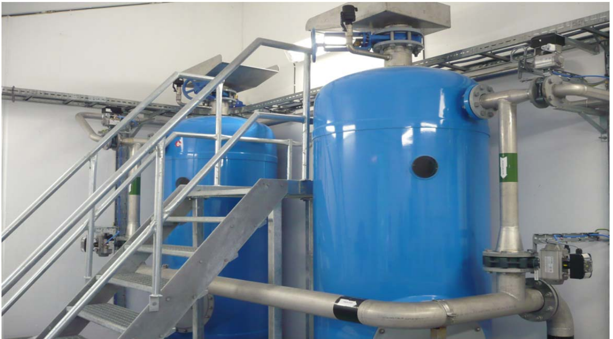
Fra vannverk for vannforsyning av Lysebotn. juni 2013
