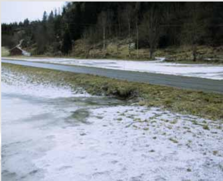
Vatn som kryr opp frå ei stikkrenne under veg og breier seg ut over engareal, danna vinteren 2003 eit samanhengande isdekke og var årsak til vinterutgang. Foto: Arve Arstein
