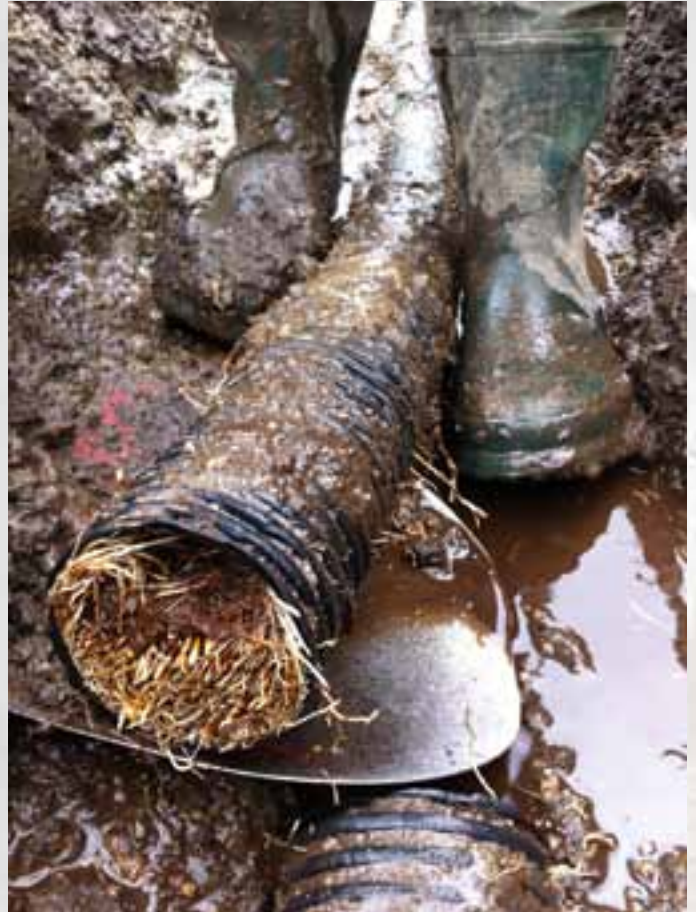
Rotinntrenging i drensrør. Foto Ståle Hustoft.
