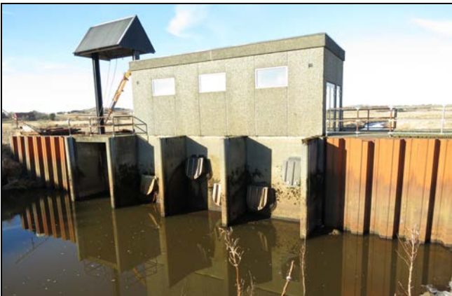
Figur 2. Pumpeinstallasjonen i Skas-Heigre. Foto Bioforsk.
