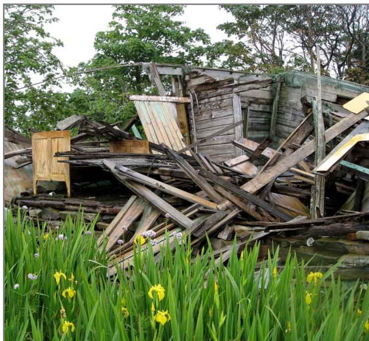
Figur 2.1. Både våningshuset og dei andre bygningane frå den siste busettinga på Gåsøy har i dag rasa saman.
