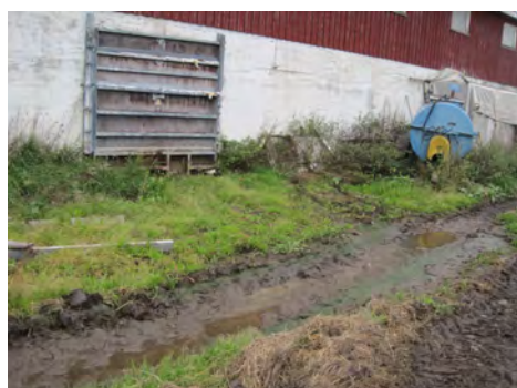
Utett gjødseleport med tydelige spor av lekkasje.
