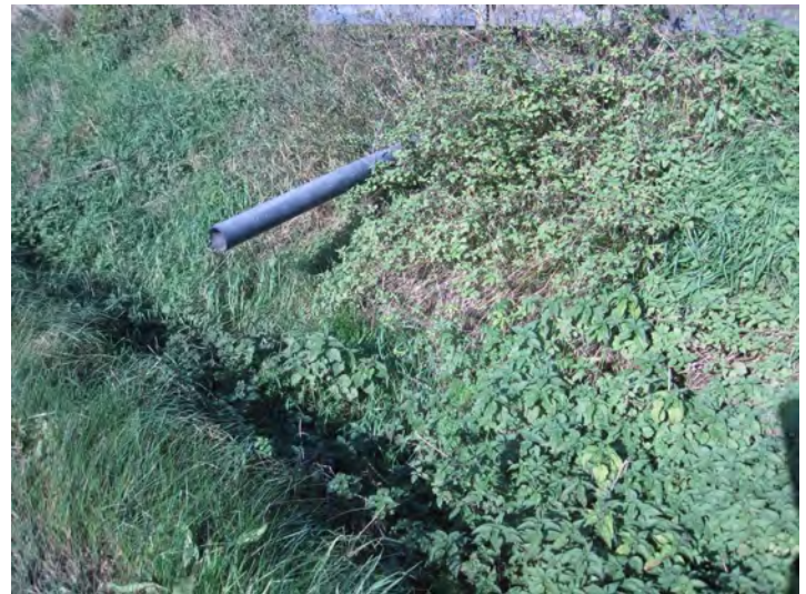
Drensrør og kraftig begroing av brennesle og annen næringskrevende vegetasjon.
