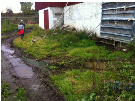
Gjødseleport med lekkasjer renner over driftsvei og nedover mot tjernet. Næringsstoffer går antakelig i drengsystemet.
